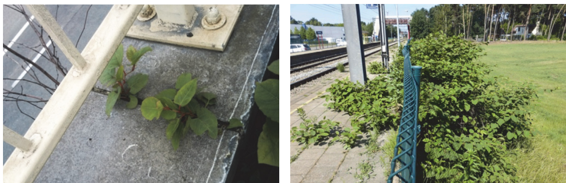
Figuur 19. Japanse duizendknoop groeit in scheuren en beschadigt bruggen (links) en spoorwegperrons (rechts).
